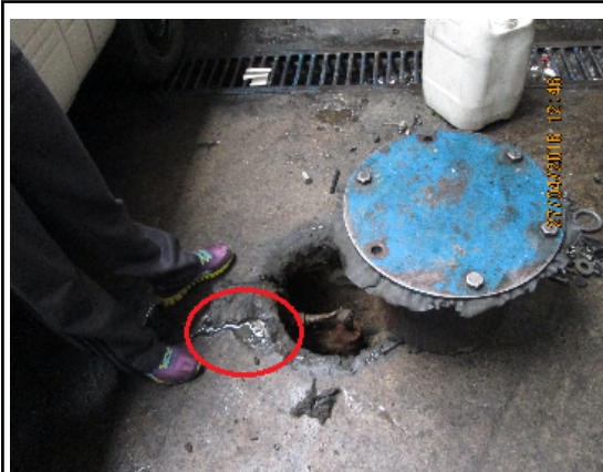
Foto No. 2. Vista del estado de la caja y la tapa que albergan la boca del pozo pz-12-0005; dentro del círculo se señala agua residual ingresando al interior de la caja.
