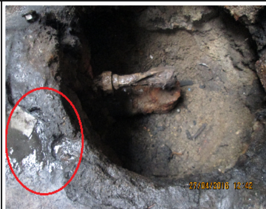
Foto No. 3. Vista del interior de la cavidad donde se localiza la boca del pozo pz-12-0005; se observa la tubería inhabilitada cubierta con sello institucional adhesivo; dentro del círculo se señala agua residual ingresando al interior de la caja.
